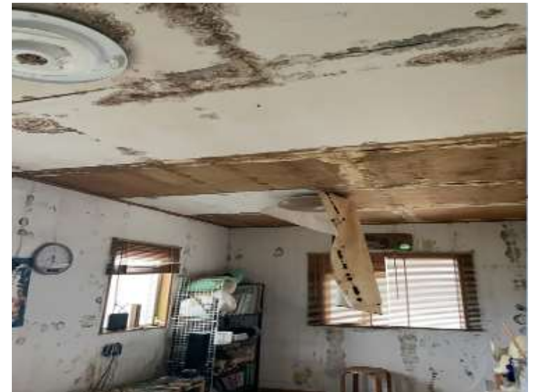
大規模半壊の家屋（室内）
